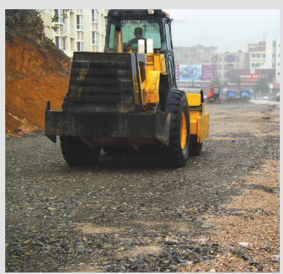
为进一步提升城市形象,优化交通道路环境,镇宁自治县去年投入2600万元修建了长1.32公里,宽45米的县城迎宾大道,目前,工程已接近尾声,预计10月份完成主体工程。图为压路机正在对路面进行碾压。
